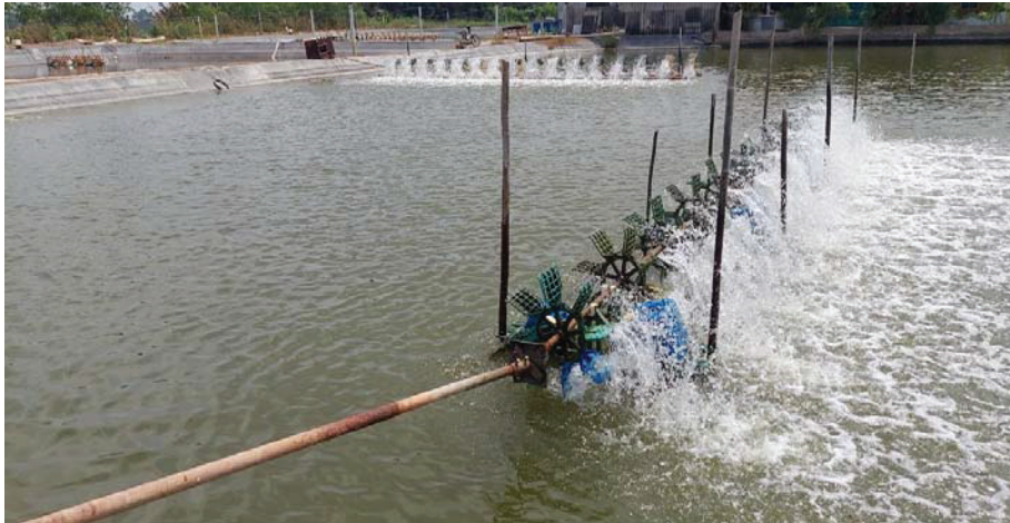
Hình 6. Hệ thống cánh khuấy được lắp đặt tại ao nuôi tôm
